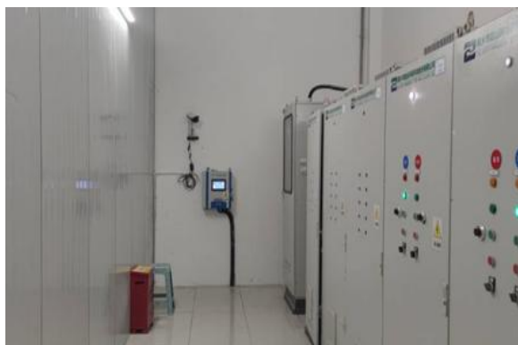
窑炉废气在线监测设备
