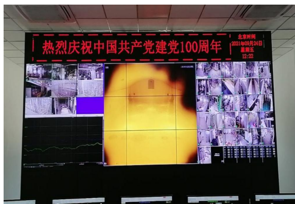
控制室设监控屏幕
