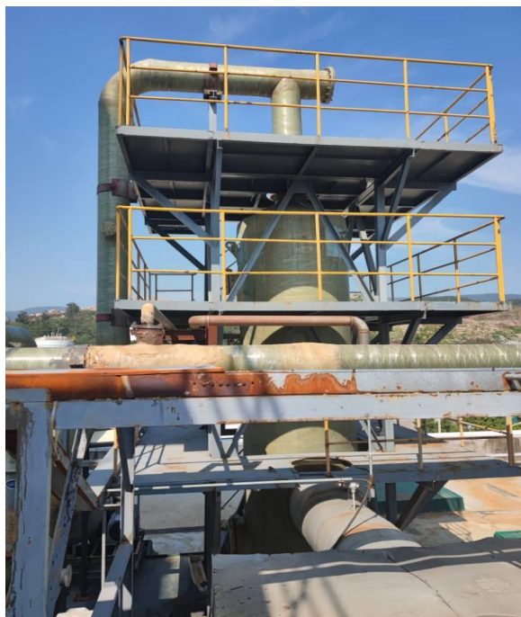
窑炉废气脱硫除氟装置
