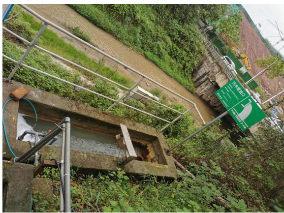
污水处理站总排放口
