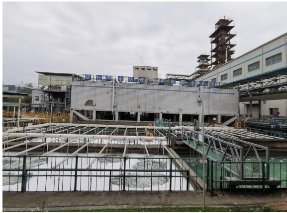
厂区污水处理站（依托）
