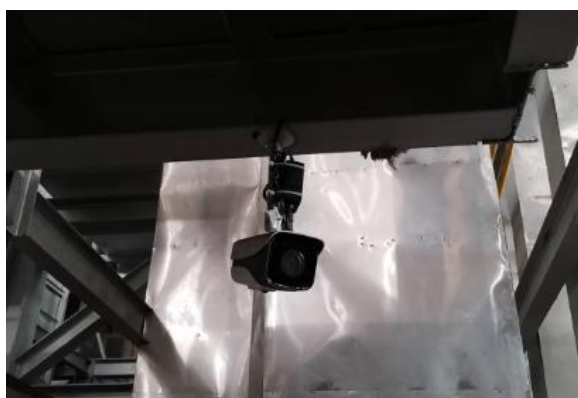
车间设视频监控探头
