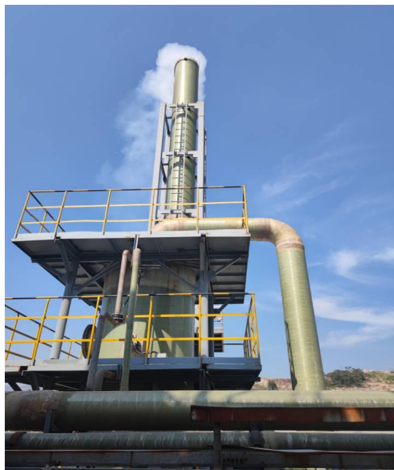
窑炉废气排放口
