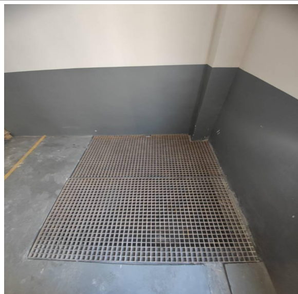
危险废物暂存间内设置收集井
