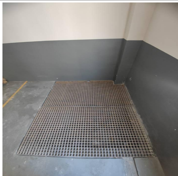
危险废物暂存间内设置收集井
