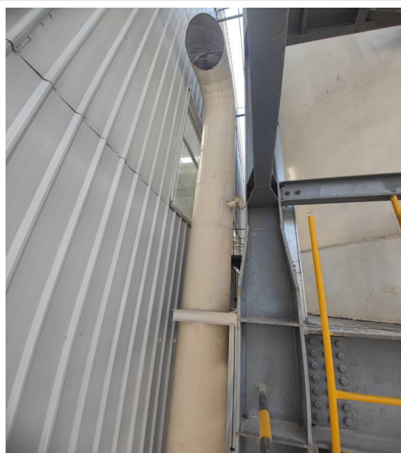
粉磨废气排放口
