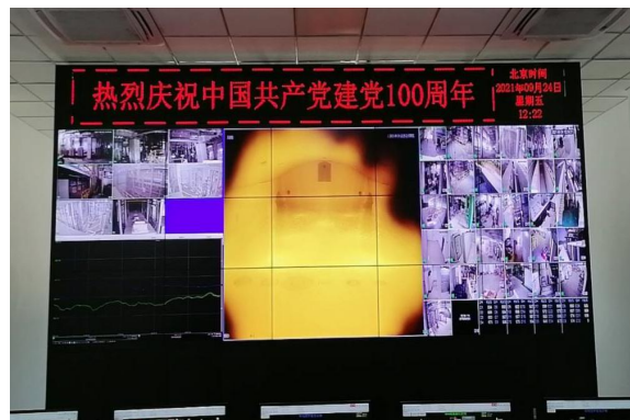
控制室设监控屏幕
