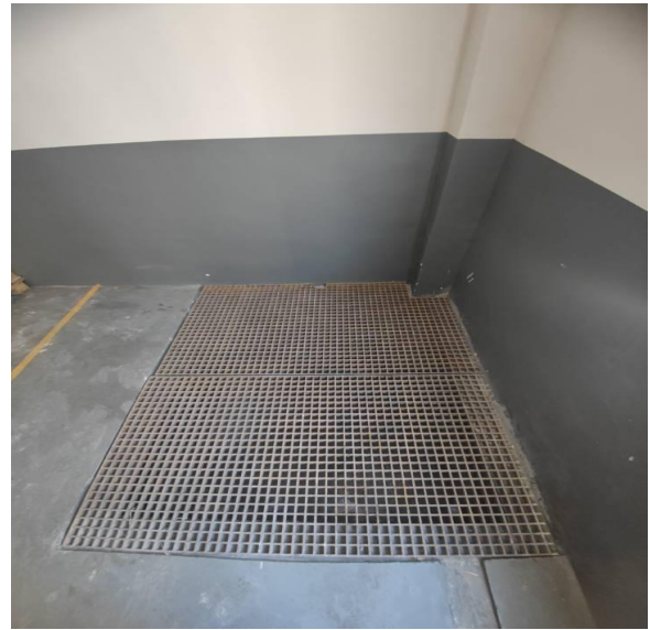
危险废物暂存间内设置收集井
