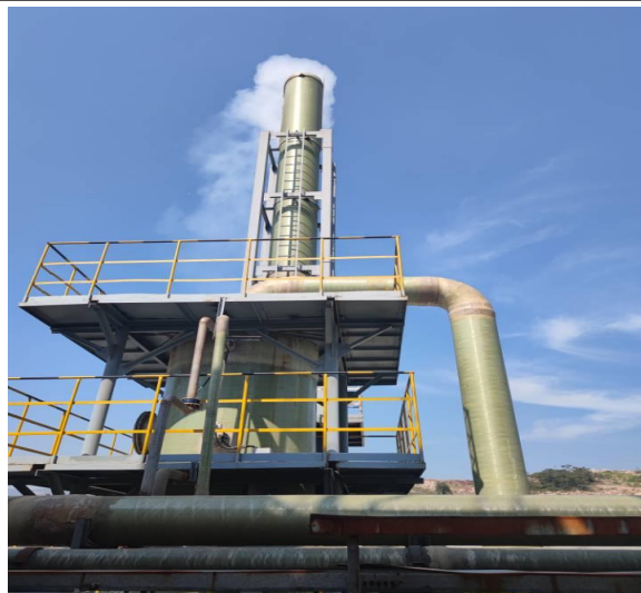
窑炉废气排放口
