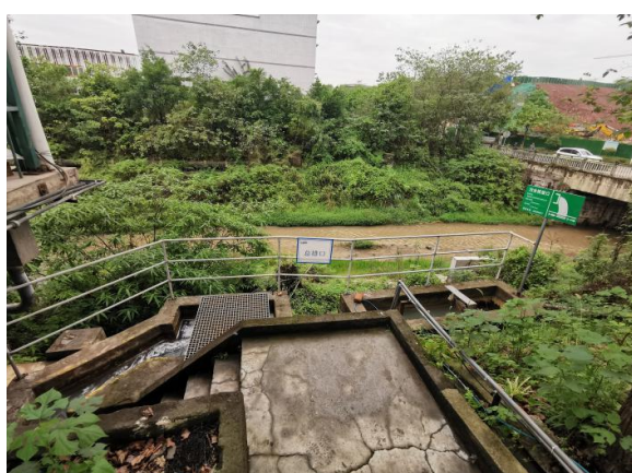
污水处理站总排放口
