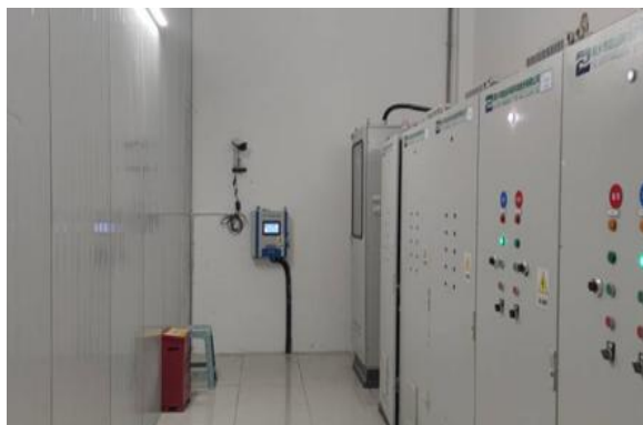
窑炉废气在线监测设备
