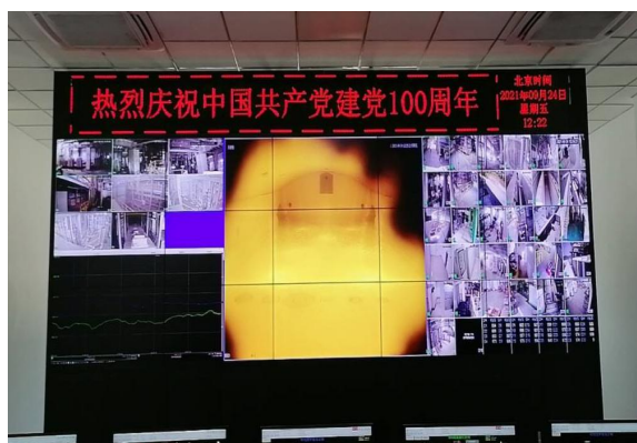
控制室设监控屏幕
