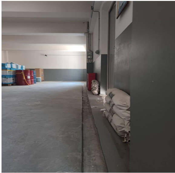
危险废物暂存间设置导流沟
