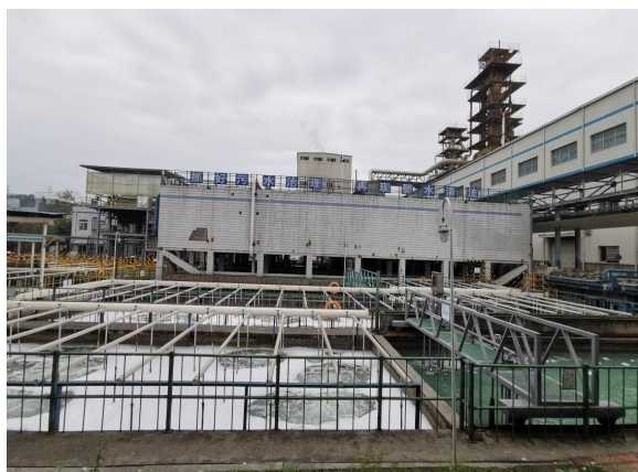
厂区污水处理站（依托）
