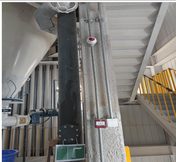
配料含尘废气排放口
