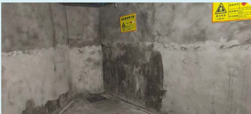
危废暂存间内部（分区、集液沟槽、防渗处理）
