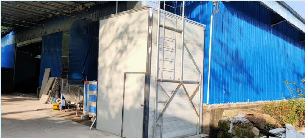
厂房密闭隔声、风机隔声降噪措施
