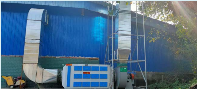
1#废气处置装置及相应排气筒
